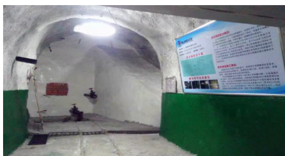
图 20 屯兰矿北一胶带巷防水闸墙
