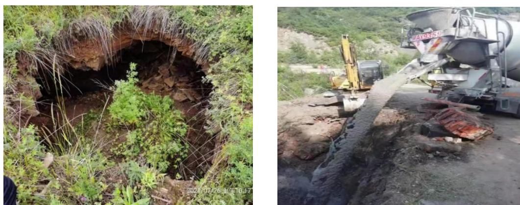
图 16 西铭矿地表塌陷坑填埋图
